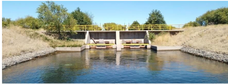
Ilustración 1-6 Vista de la obra de captación La Picacita- compuertas automáticas
