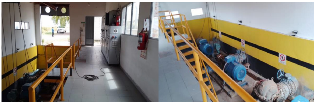
Ilustración 1-9 Estación de bombeo
